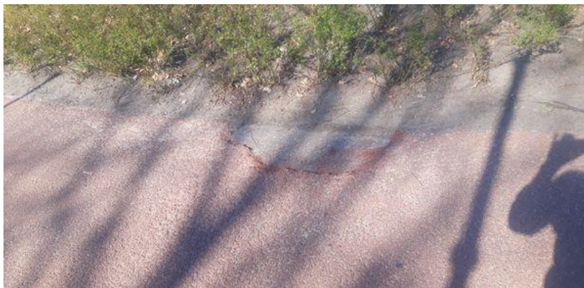
1] Rotonde De Reede: gaten in het fietspad
